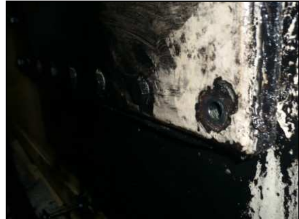
Tête de vis manquante sur la trappe de visite de la caisse à gazole bâbord
