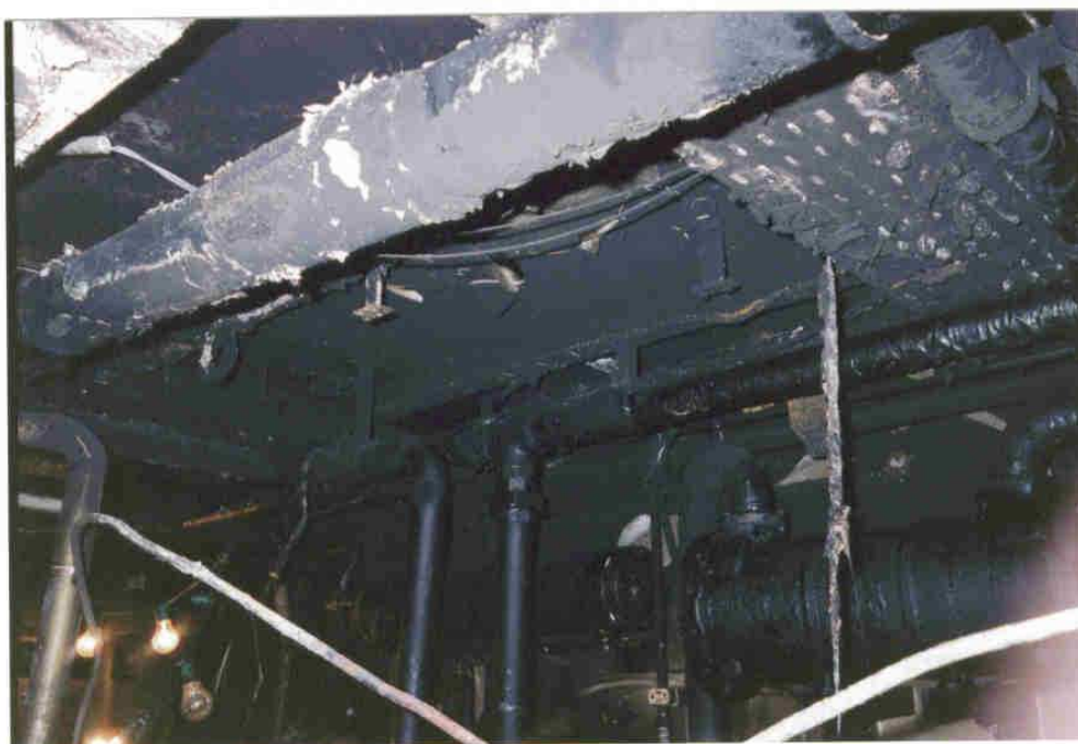
Plafond du compartiment machine après le feu.
