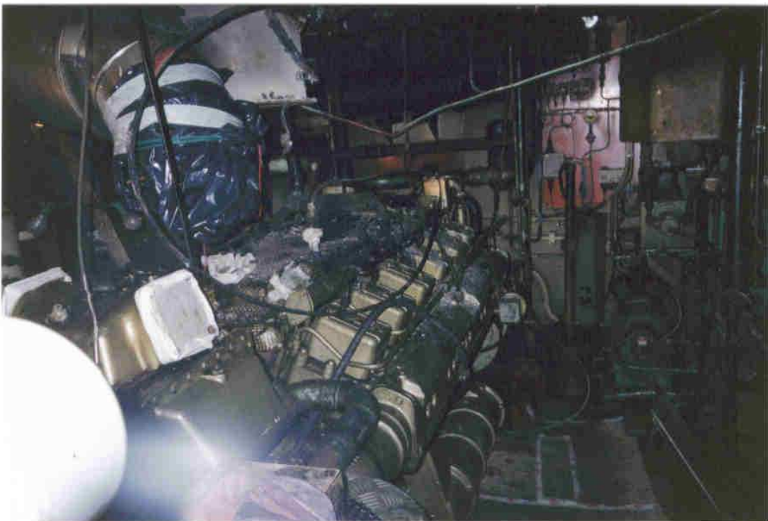
Moteur de propulsion après l'incendie.
