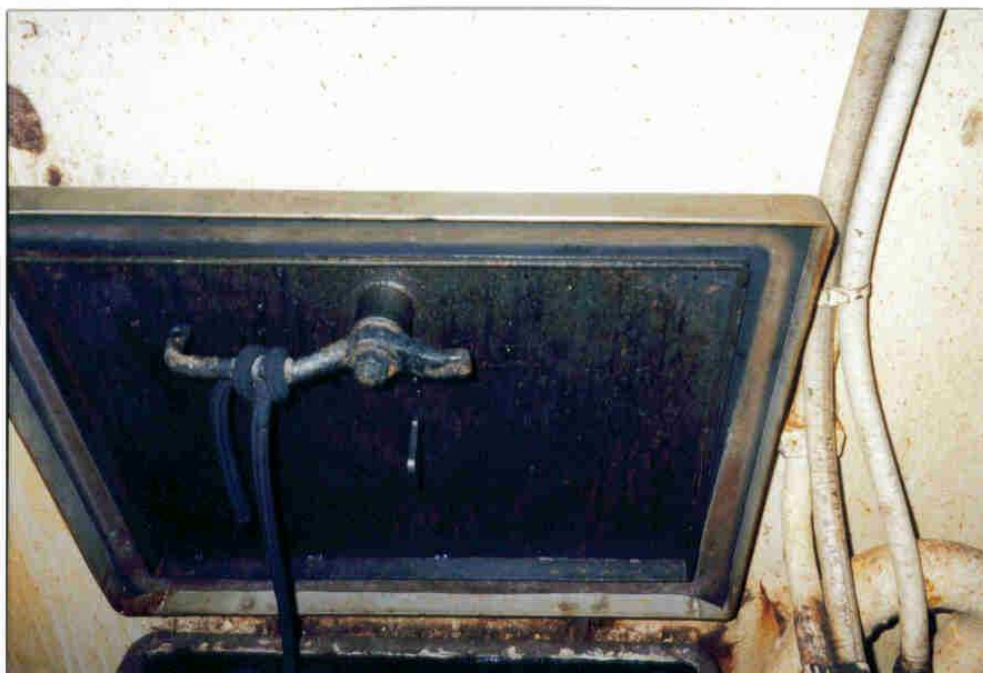
Echappée machine tribord, taquet de fermeture verrouillé à l'intérieur par un bout.
