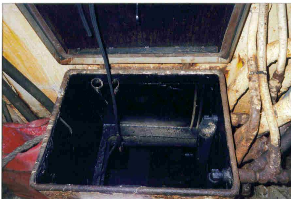
Echappée machine tribord, anneaux de commande des fermetures à distance des vannes des caisses à combustible inaccessibles en cas d'incendie.
