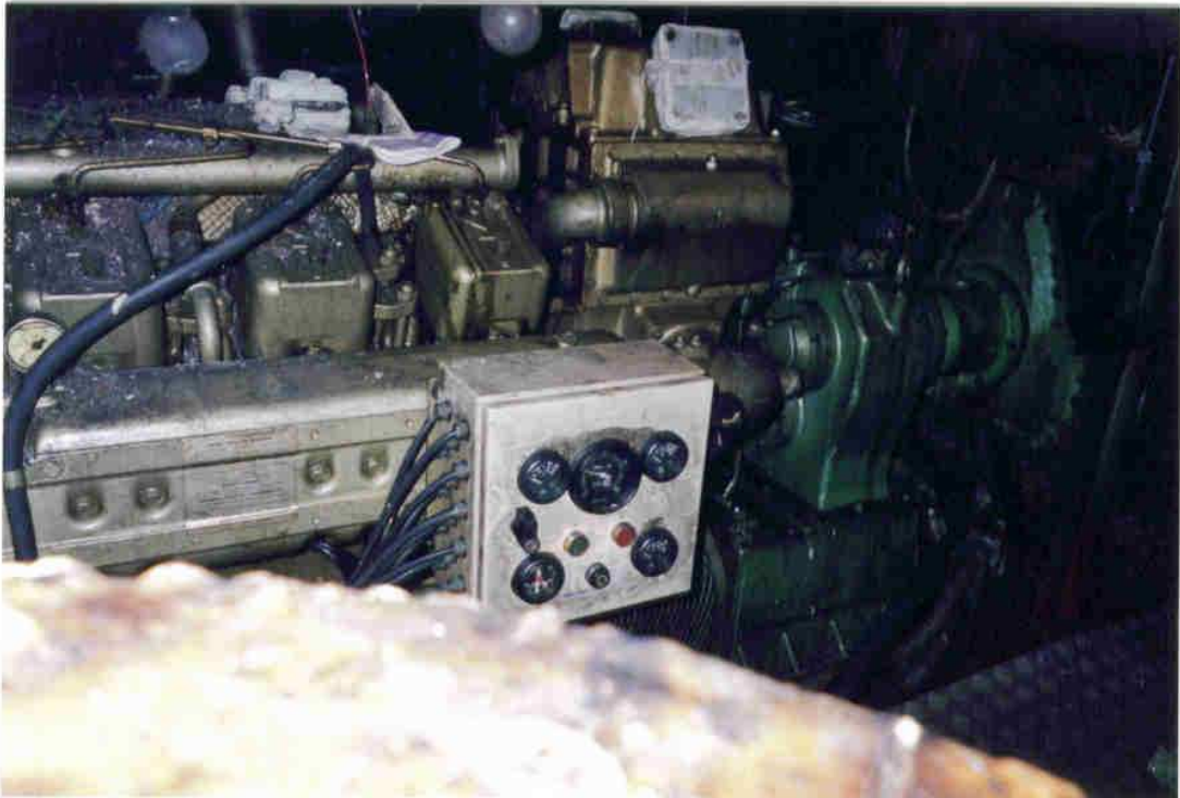
Moteur de propulsion – Coffret commande locale.
