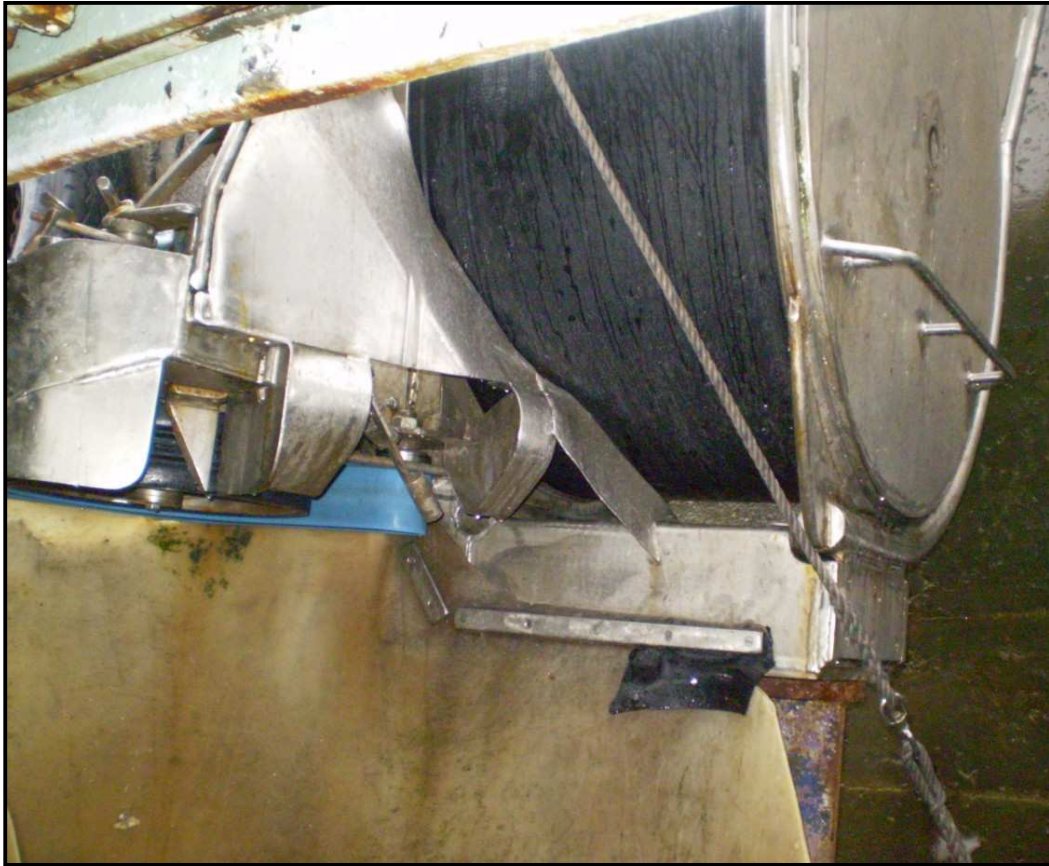
Power-block côté pont.
