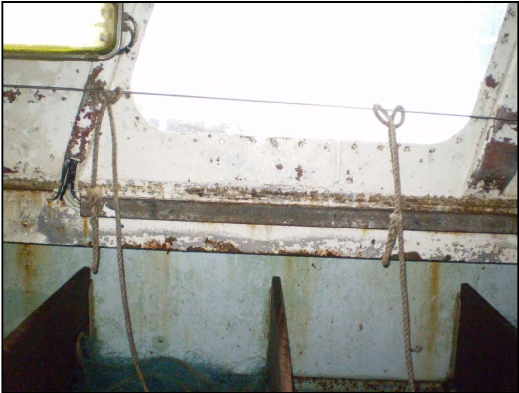
Câble supérieur du tuyau hydraulique et orins amarrés.
