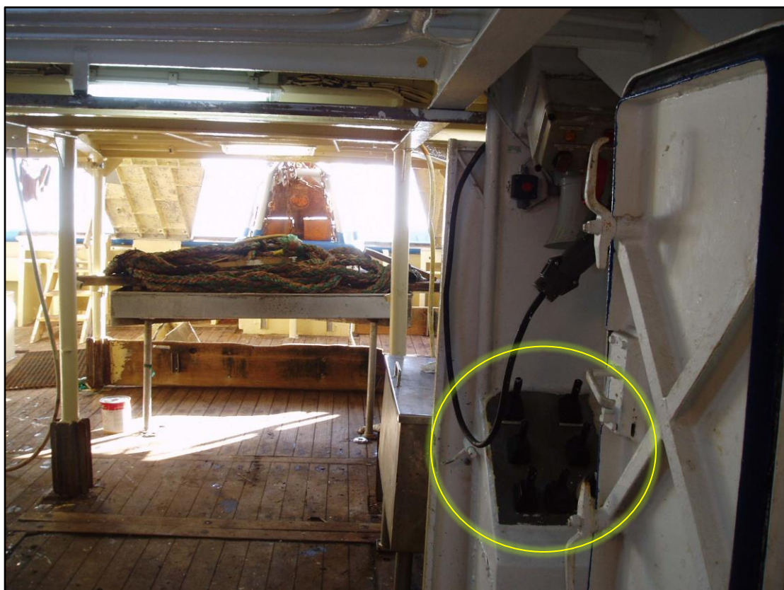
C2 : Poste de commande treuils d'enrouleurs / winch control panel
