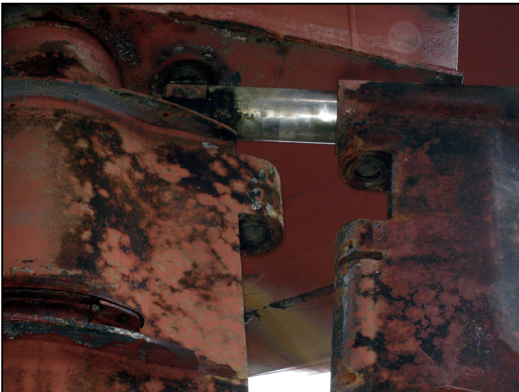
Vue du coulisseau de la transmission mécanique du volet : l'aspect de la surface de l'axe montre que l'avarie est relativement récente. L'axe de la charnière supérieure n'est plus en place.
