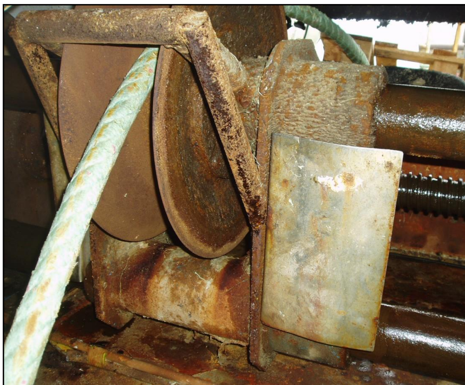
Réa et une tôle de détection du guide-câble.
