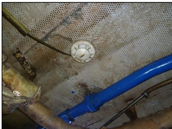
Capteur incendie - Plafond machine
